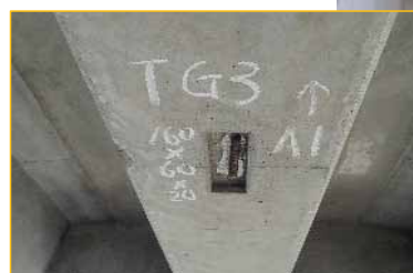
&lt; 剥離・鉄筋露出の供試体 &gt;
