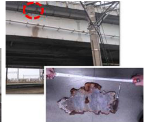
腐食片の落下
