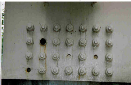
高力ボルトの脱落
