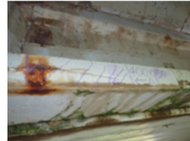
内部の鉄筋腐食が疑われる例
