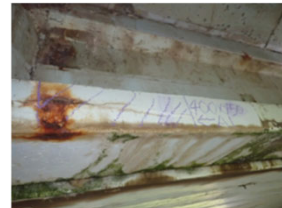
内部の鉄筋腐食が疑われる例
