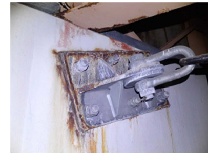
アンカーボルトの腐食
