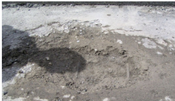
床版上面の土砂化
