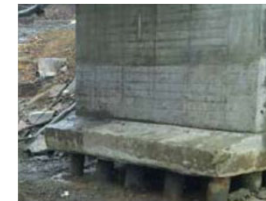
杭基礎の露出
