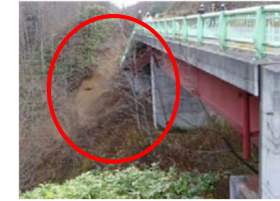
斜面上基礎の洗掘
