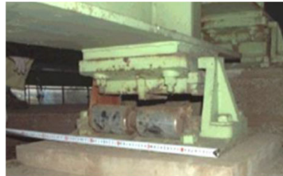
ローラーの脱落
