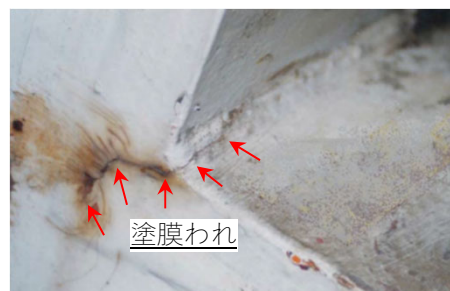
塗膜われ(疲労亀裂)
