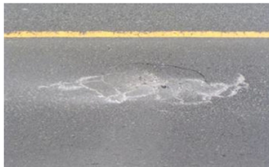
舗装のひびわれから白色析出物
