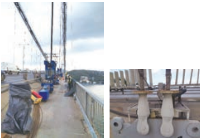
写真-15・16 第2ボスボラス橋・ガセットプレート
