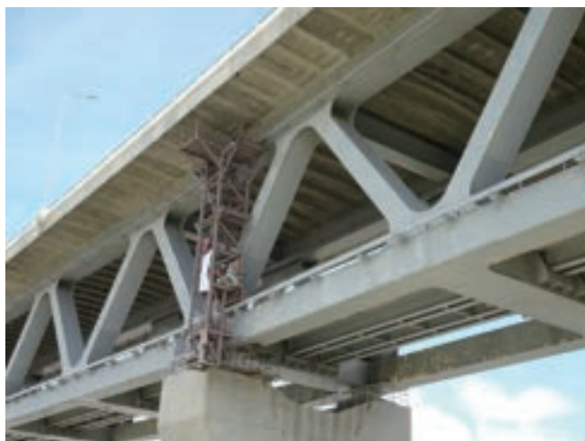
写真-23 メンテナンス用移動式足場
