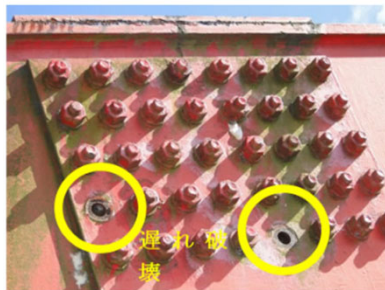
ボルトの脱落
