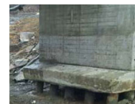
杭基礎の露出
