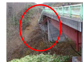
斜面上基礎の洗堀
