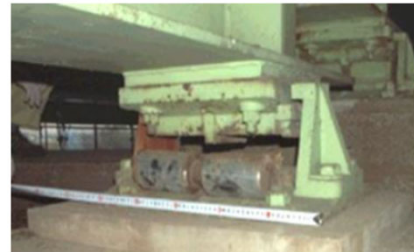
ローラーの脱落
