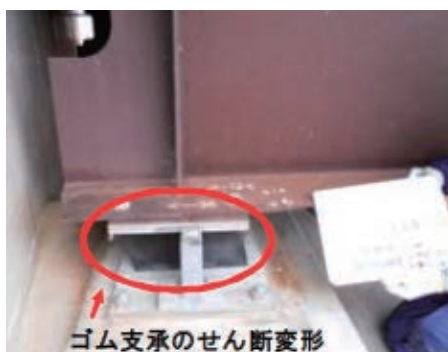
(d) 地震時ゴム支承の残留変形
