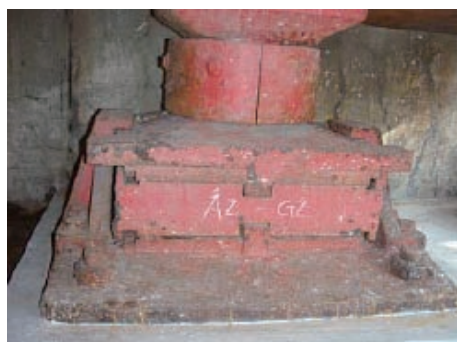
(a) 発錆・腐食による損傷
