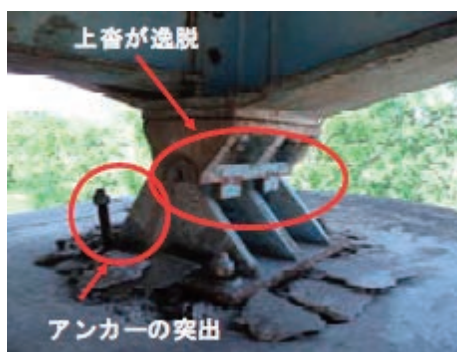
(c) 地震時ピン支承の損傷
