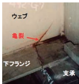
(b) 機能不全により主桁に亀裂が発生した事例
