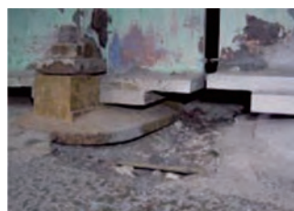
写真-8 支承の沈下
