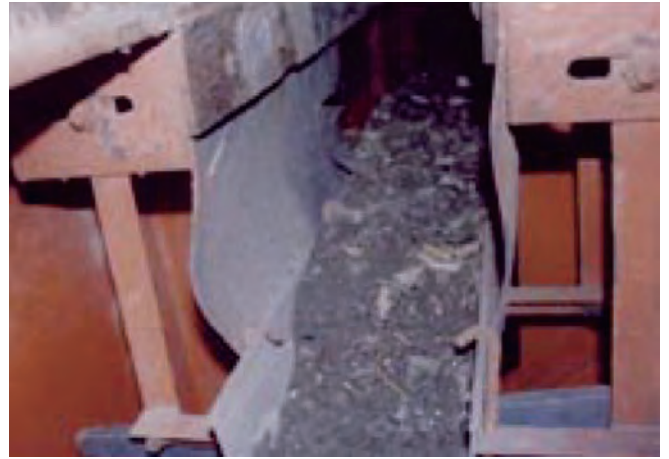
写真-4 目地部の土砂堆積（排水機能の喪失）
