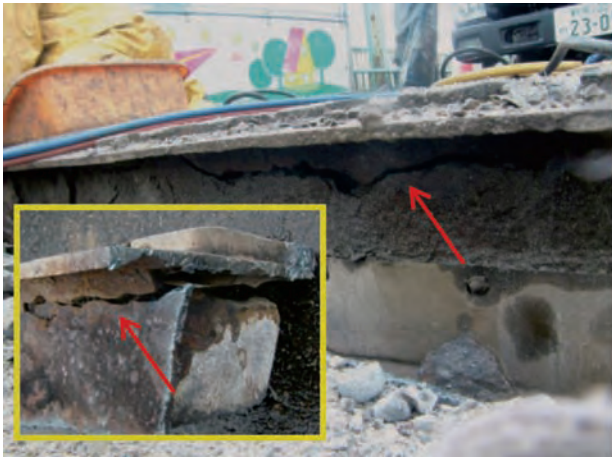
写真-3 ウェブプレートの亀裂・破断
