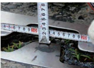
写真-7 フィンガー部の段差
