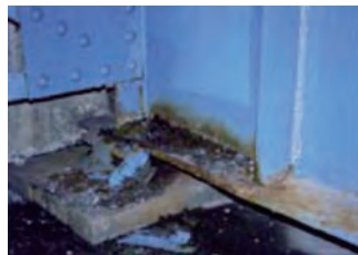
写真-6 桁端部の腐食
