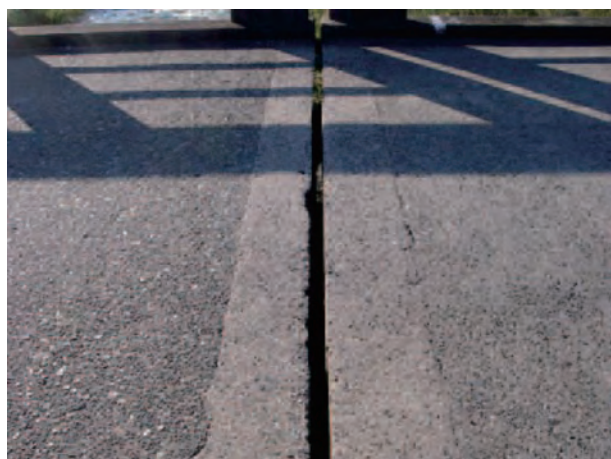
写真-1 目地材の脱落
