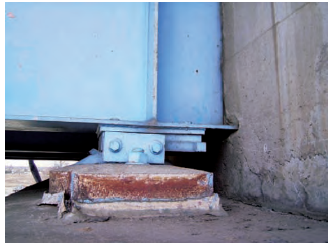
写真-10 桁遊間の異常と支承の異常移動
