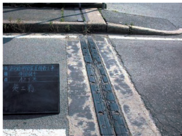
写真-2 表層ゴムの損傷
