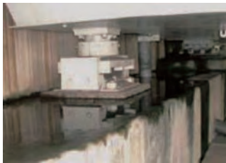
写真-5 橋座面の滞水
