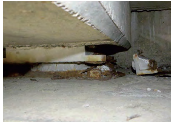
写真-26 支承のサイドブロックの変形・破断 (国道45号 歌津大橋)
