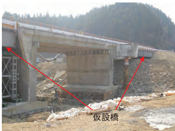
流出した橋台背面土工部に仮設橋が設置されている。 写真-28 橋台背面土工部の流出 (国道45号 二十一浜橋)
