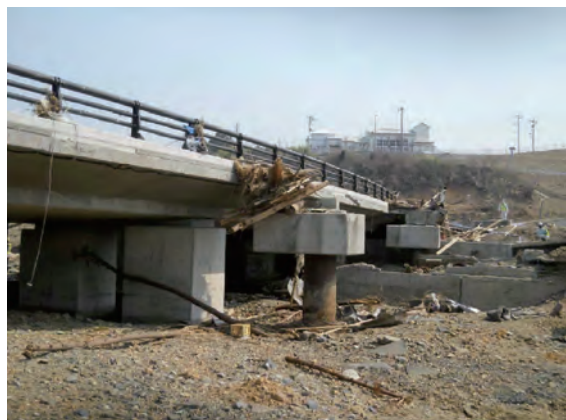
写真-18 橋側歩道橋主桁 (PCT桁) の流出 (国道45号 外尾川橋側道橋 (下り))
