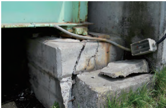
写真-5 橋台のひびわれ (国道45号 天王橋歩道橋)
