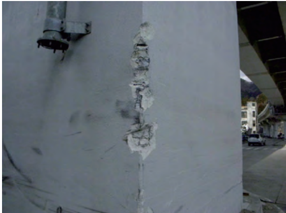
写真-23 橋脚の漂流物衝突による破損 (国道45号 釜石高架橋)
