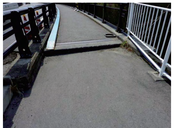
歩道部の路面段差 (段差 2 cm 以上)
