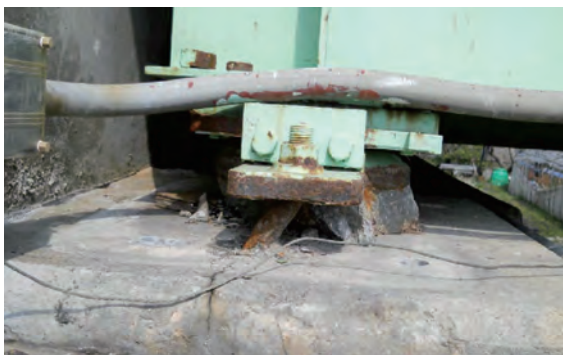
写真-7 アンカーボルトの変形 (国道45号 天王橋歩道橋)
