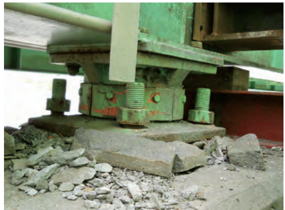
写真-9 沓座モルタルのひびわれ・欠損 (国道45号 天王橋歩道橋)
