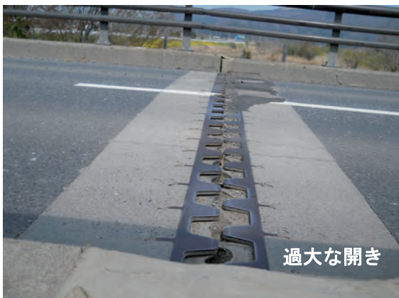
写真-12 伸縮装置の遊間異常 (橋軸方向) (国道45号 天王橋)
