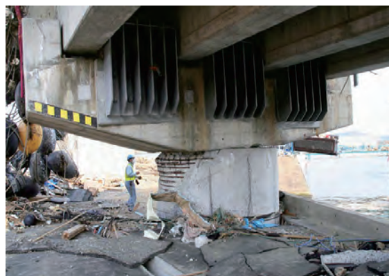
写真-22 橋脚の破損 (国道45号 歌津大橋)
