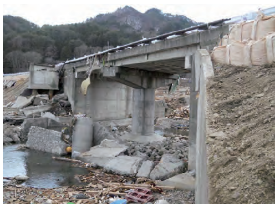
写真-19 橋側歩道橋主桁 (鋼H桁) の流出 (国道45号 浪板橋側道橋 (上り))
