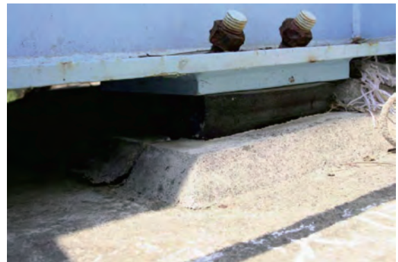
写真-27 アンカーボルトの変形・抜け出し (国道45号 大沢第二橋側道橋 (上り))
