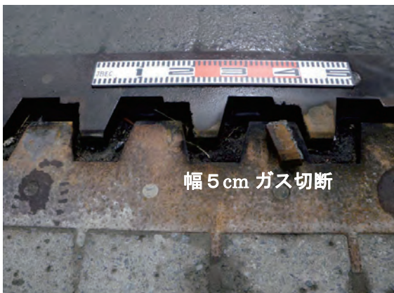
写真-13 伸縮装置の遊間異常 (橋軸直角方向) (主要地方道塩釜巨理線 関上大橋)
