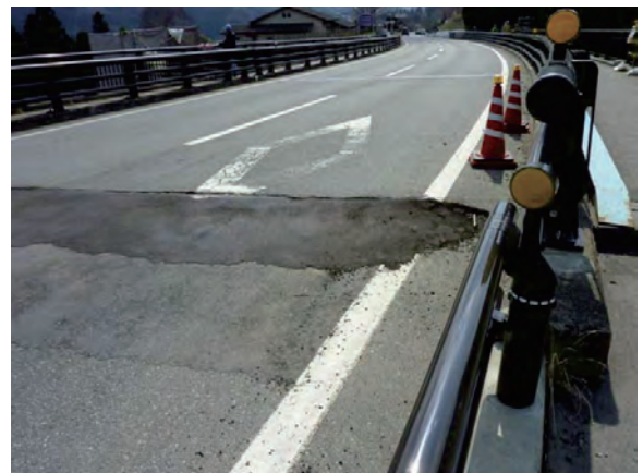
車道部の路面段差 (すりつけによる応急処置)
