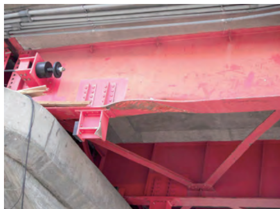
写真-20 主桁の漂流物衝突による変形 (国道45号 片岸大橋)
