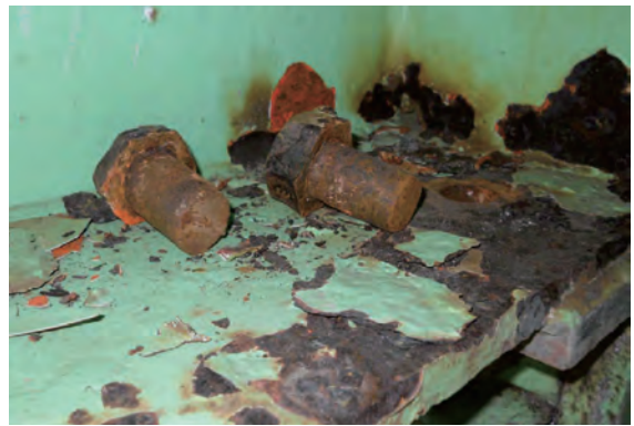
写真-8 セットボルトの破断 (国道45号 天王橋)
