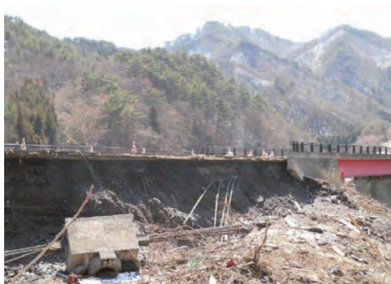
写真-29 橋台背面土工部の洗掘 (国道45号 鳥谷坂橋)
