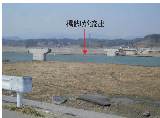
写真-21 橋脚の流出 (国道45号 小泉大橋)
