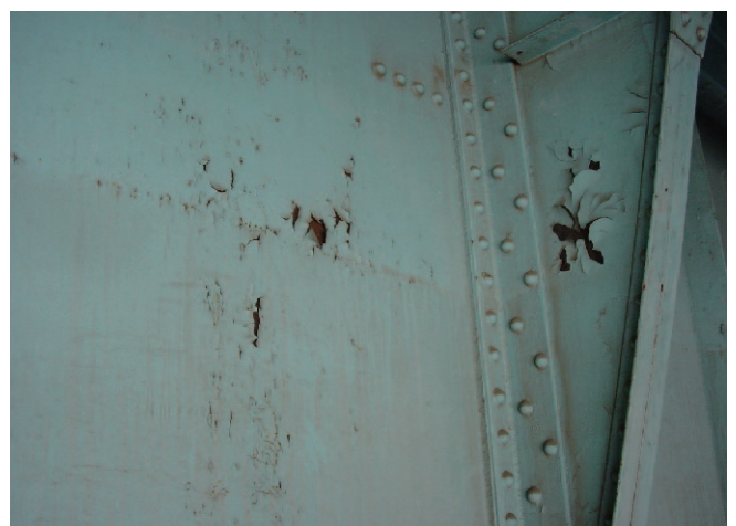
写真-2 再塗装前の主桁塗装の劣化状況 変色、剥離、割れが生じ、鋼材表面には錆が認められる。
