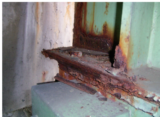
写真-1 桁端部に発生した主桁腐食の事例
