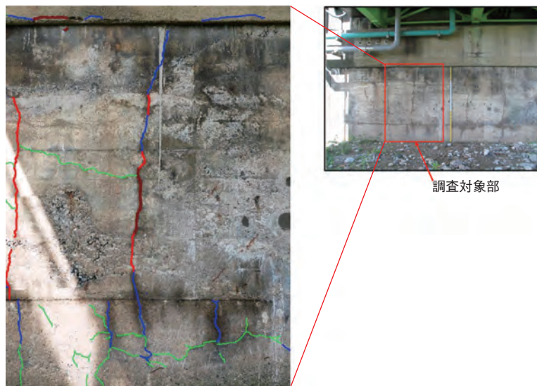
図二 橋台のひびわれ解析の事例
