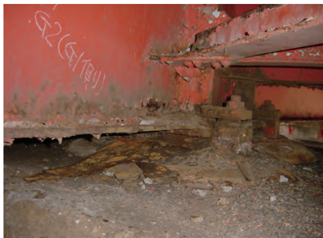
写真-1 腐食の進んだ桁端部と支承
