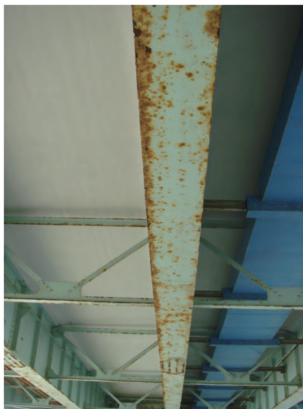
写真-2 下フランジの角からの腐食
