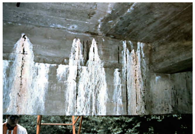
写真-3 コンクリート桁に生じている遊離石灰
