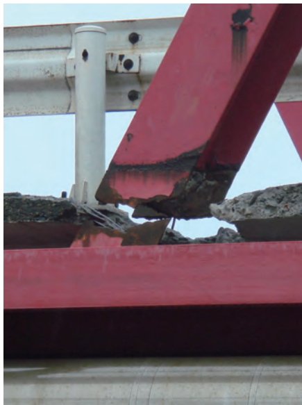
写真-7 トラス斜材の破断
