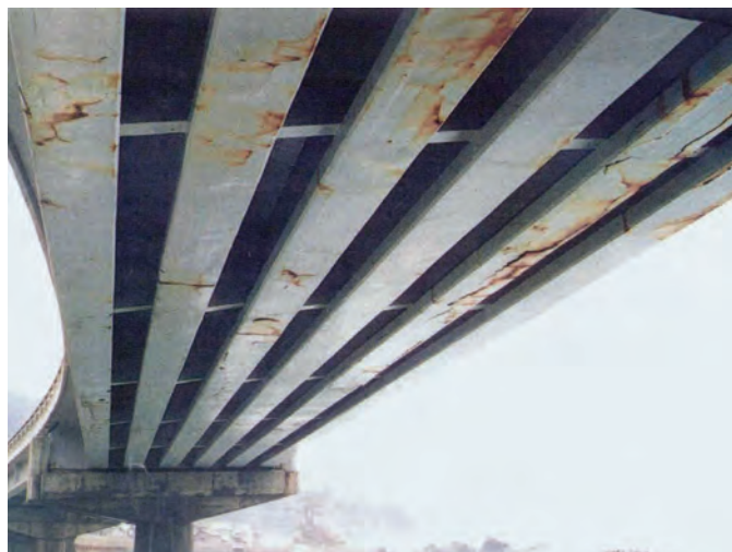
写真-6 塩害によるPC桁の損傷
