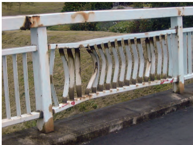
写真-1 車両の衝突により大きく変形した高欄
