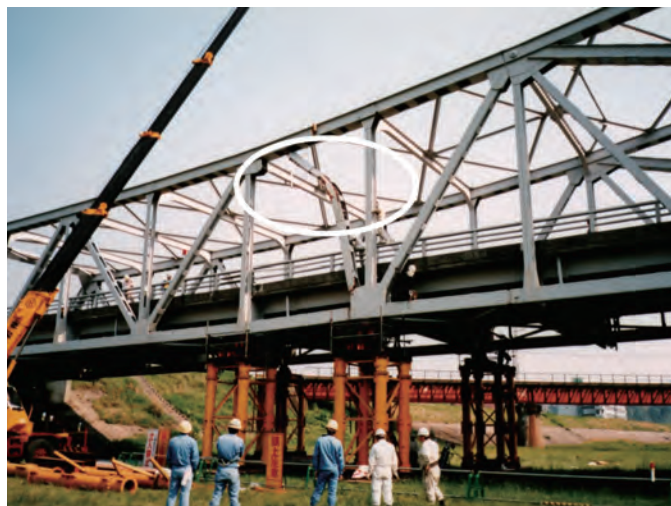
写真-2 トラス主構が損傷を受けることもあります。
