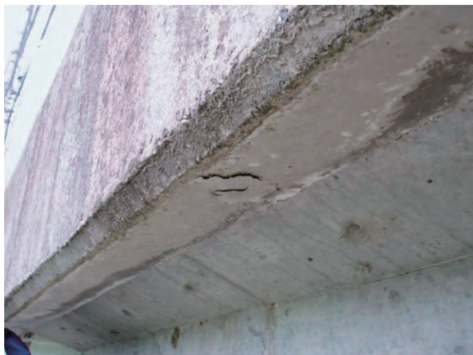
写真一七 壁高欄の下面に生じたうき
