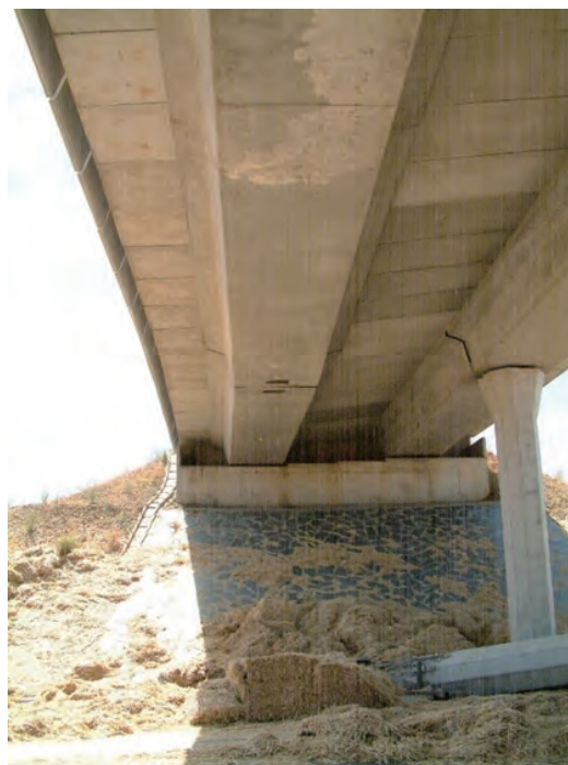
写真-11 P1橋脚の倒壊
