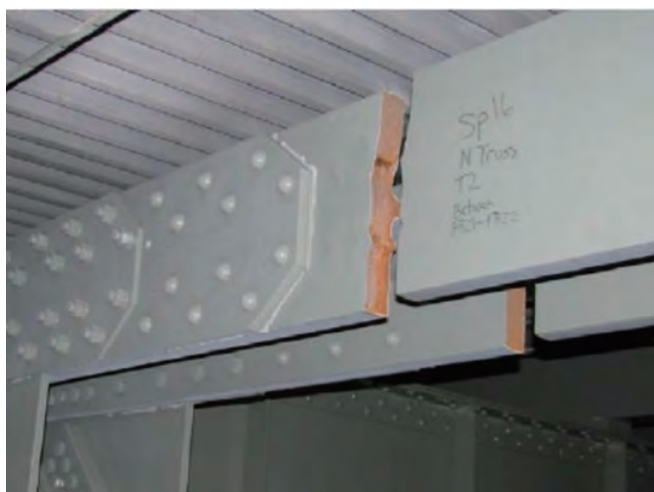
写真-10 トラス上弦材の破断状況
