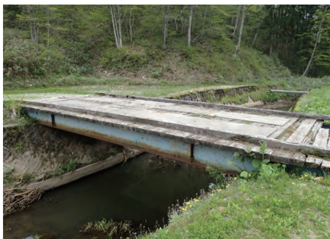
写真-6 改修前の農道橋（秋田県大仙市）
