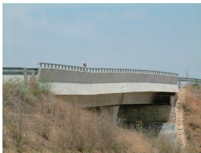
写真-12 主桁、床版の変形状況
