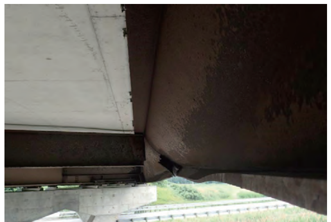
写真-8 西側の主桁の損傷
