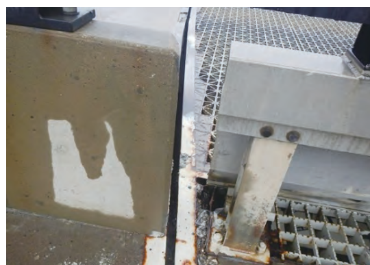
写真-6 グレーチング床版近景 (橋面からの排水が垂れ流しになっていました)
