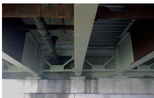
写真-8 床版下面の状況 (鋼製型枠が車道部で使われていました)
