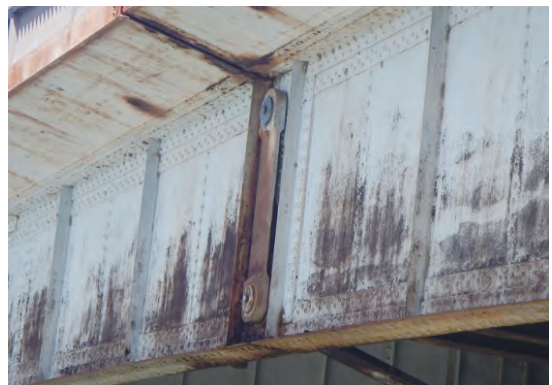
写真-10 スパン中央のヒンジ (ヒンジからの漏水が顕著でした)
