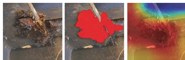
(a) 点検損傷度 (d) ⇔ CNN 損傷度 II (TN)
