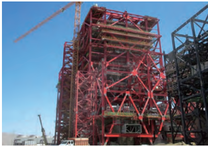
写真-2.11 ボイラープラント
