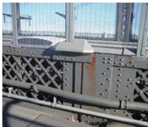
写真-8 高欄の錆汁状況
