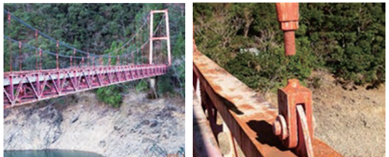
写真-4 特殊形式(吊橋)の主要部材の破断
