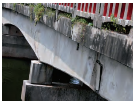
コンクリート橋 ヒンジ部の損傷
