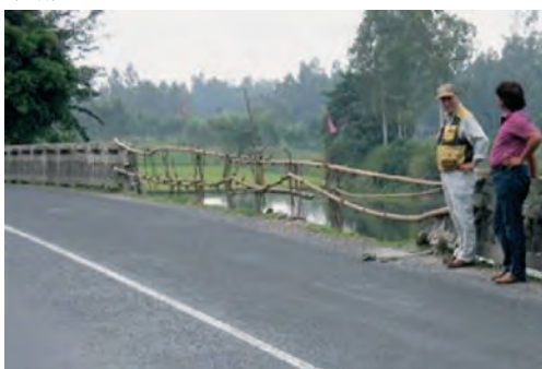
コンクリート橋 防護柵の欠損
