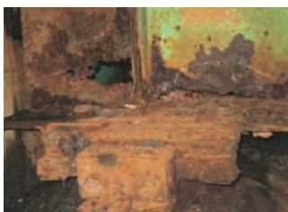
写真-1 桁端部の劣化と支承の機能障害 1)
