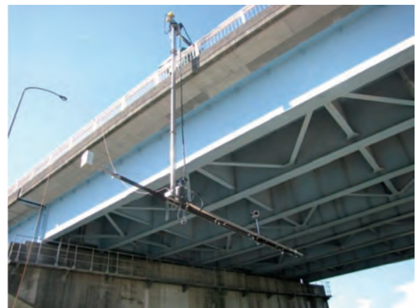
写真-4 歩道上の車両系作業車から伸ばした点検アームで点検 (新浅川橋)
