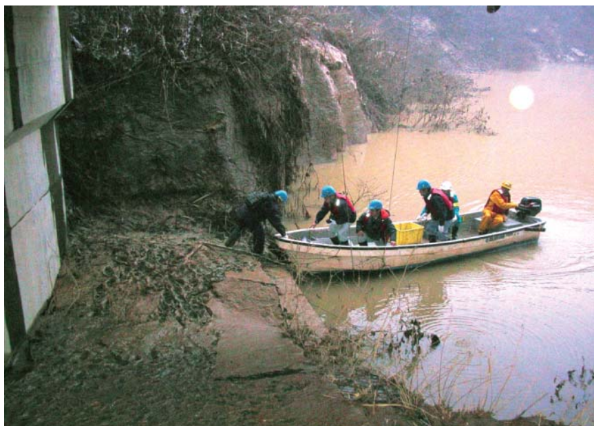
写真-2 地震によりできた湖から橋台に接近する国道291号被災橋梁調査団
