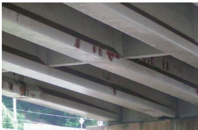
写真-2 塩害を受けた橋梁
