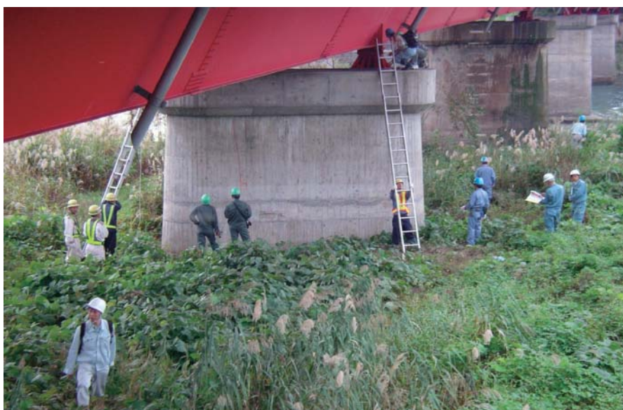
写真-1 新潟県中越地震による被災橋梁補修検討会の調査状況
