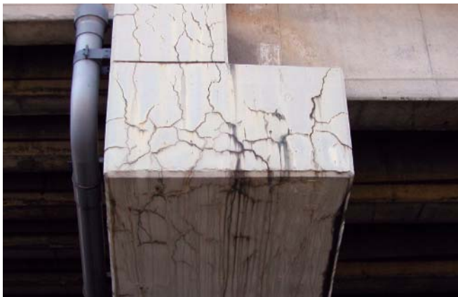
写真-3 アルカリ骨材反応と判定された橋脚
