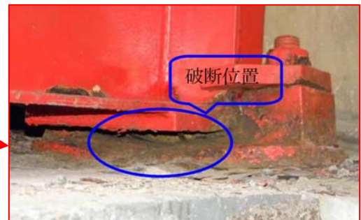
段差発生部の直下における支承の破断
