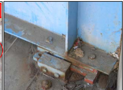
可動支承 可動支承の遊間異常
