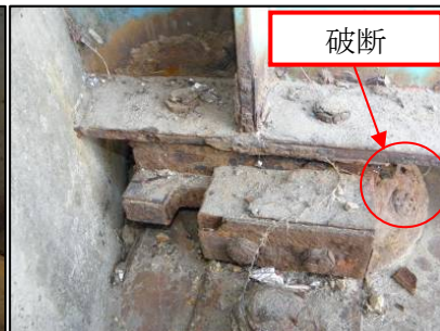
固定支承 上沓ストッパーの破断
